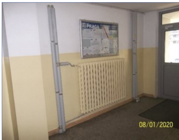
Prałatowska 6 - klatka przed remontem
